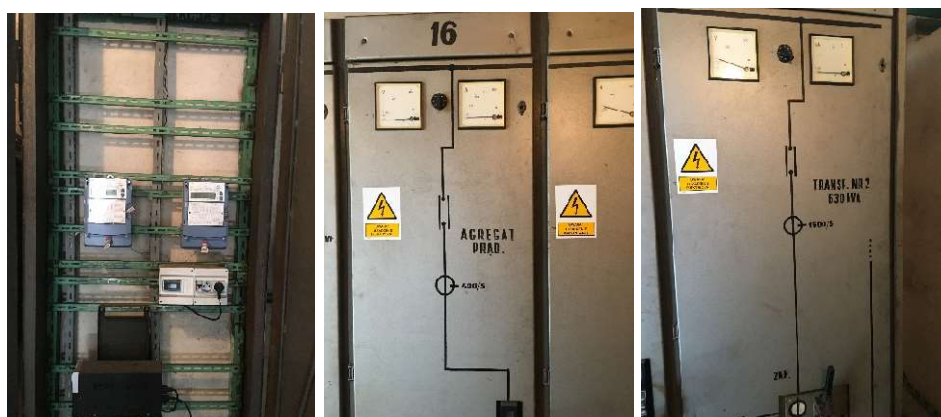
Rysunek 5 Widok na pola pomiarowego, oraz agregatu i transformatora
